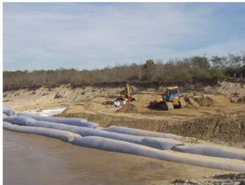
Fig. 23. Mis à nu des tubes géotextiles pendant la phase travaux durant une tempête fin 2002/début 2003 (source : Artières et al., 2004)
